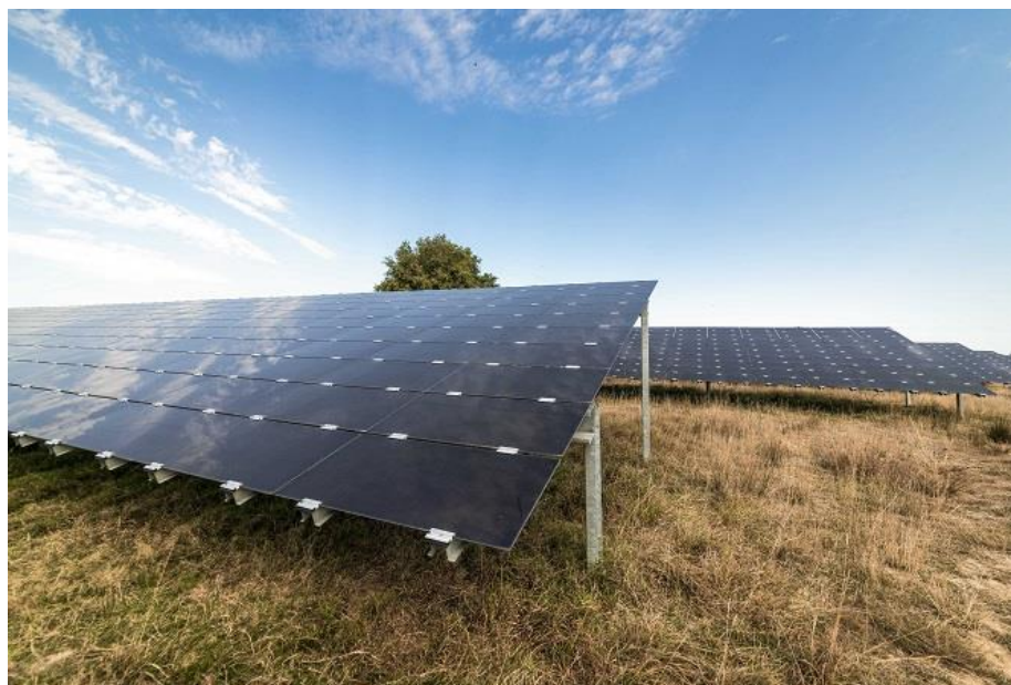
Centrale photovoltaïque de Saint Eusèbe en Saône et Loire – Obligation durable 2019
